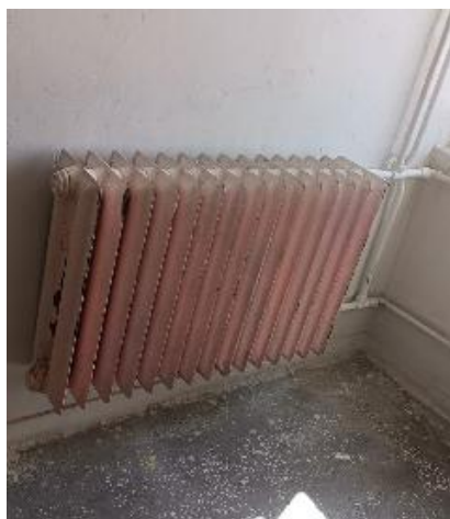
暖房設備 (頻繁に故障)
