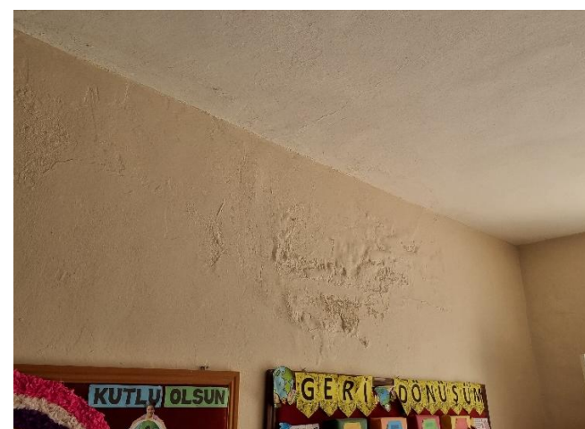
内壁 (ひび割れと変形)
