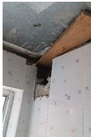
トイレ内壁 (一部崩落)
