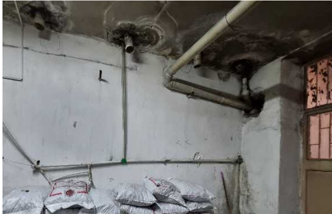
Su sızıntısı meydana gelen kanalizasyon boruları
