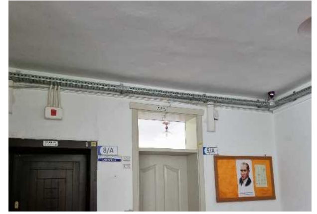
Eskimiş elektrik tesisatı
