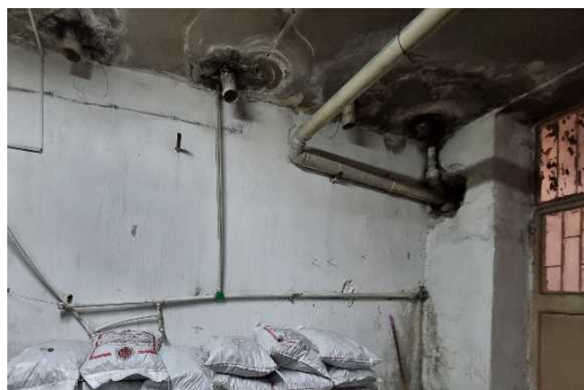
漏水が発生している地下の下水管
