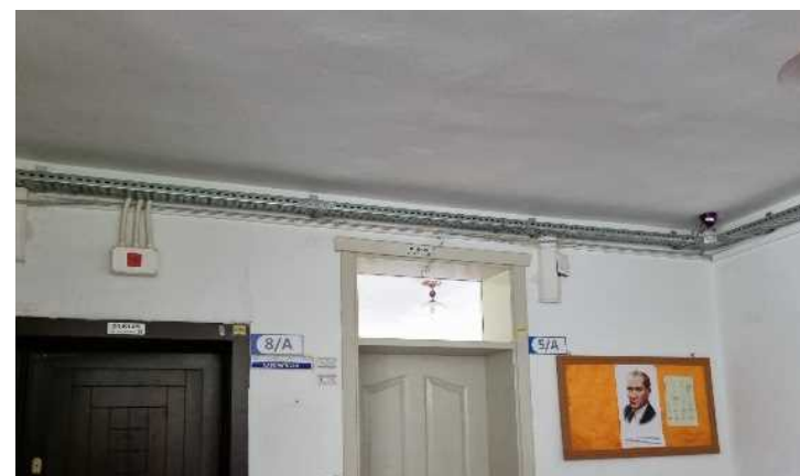
古い電気設備
